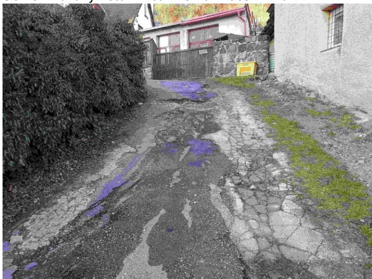
Obr. 5: Havarijní stav místní komunikace Příkrá
