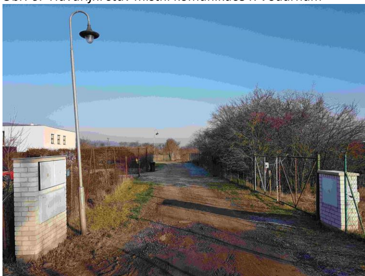
Obr. 6: Havarijní stav místní komunikace K Vodárnám
